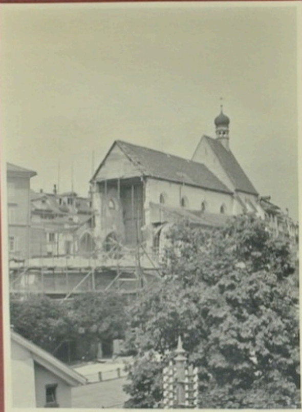
Turm Westteil der Kirche sind abgebrochen.
