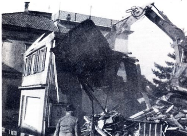
Eine grosse Baggerschaufel riss das Farbhaus um
